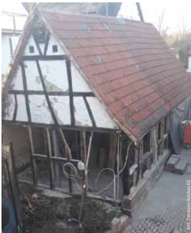
Große Teile der ursprünglichen Substanz musste erneuert werden, da viele Bauteile durchfeuchtet und verfault war.
