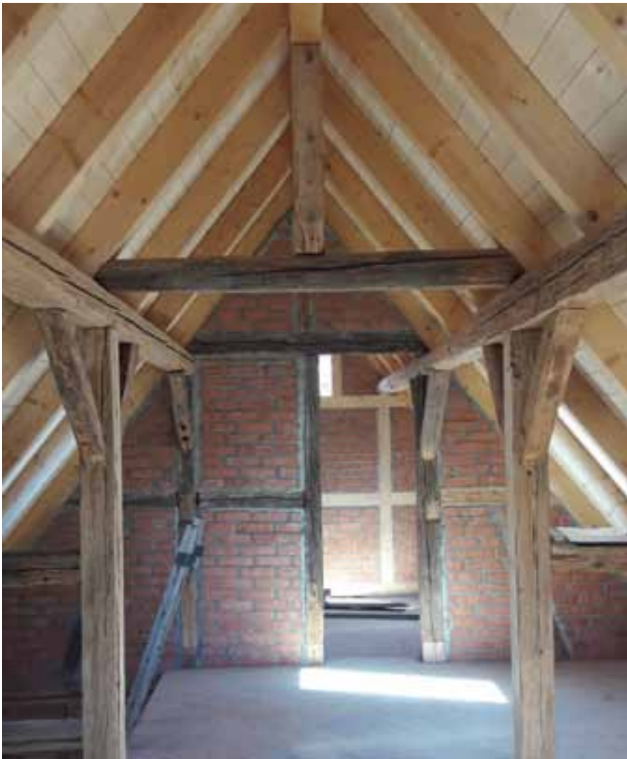
Das Dachgebälk musste größtenteils erneuert werden, nur die ursprünglichen Mittelpfetten und die Pfosten konnten verbleiben.
